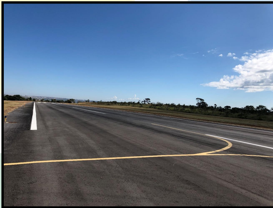
Figura 3 - Pista de pouso e decolagem
